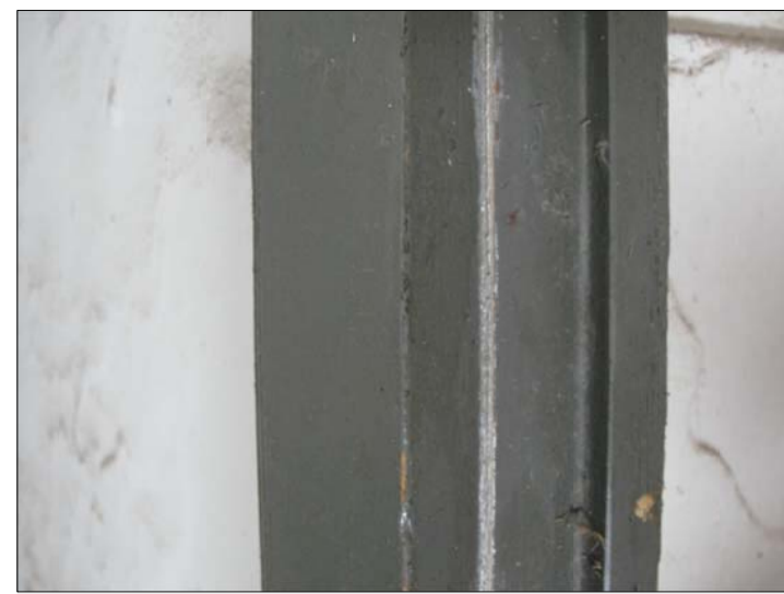
Restos de lo que parece ser la pintura original de la carpintería interior, que se empleará como referencia para la pintura de carpintería de madera y el lacado de la periferia de aluminio de la carpintería exterior.
